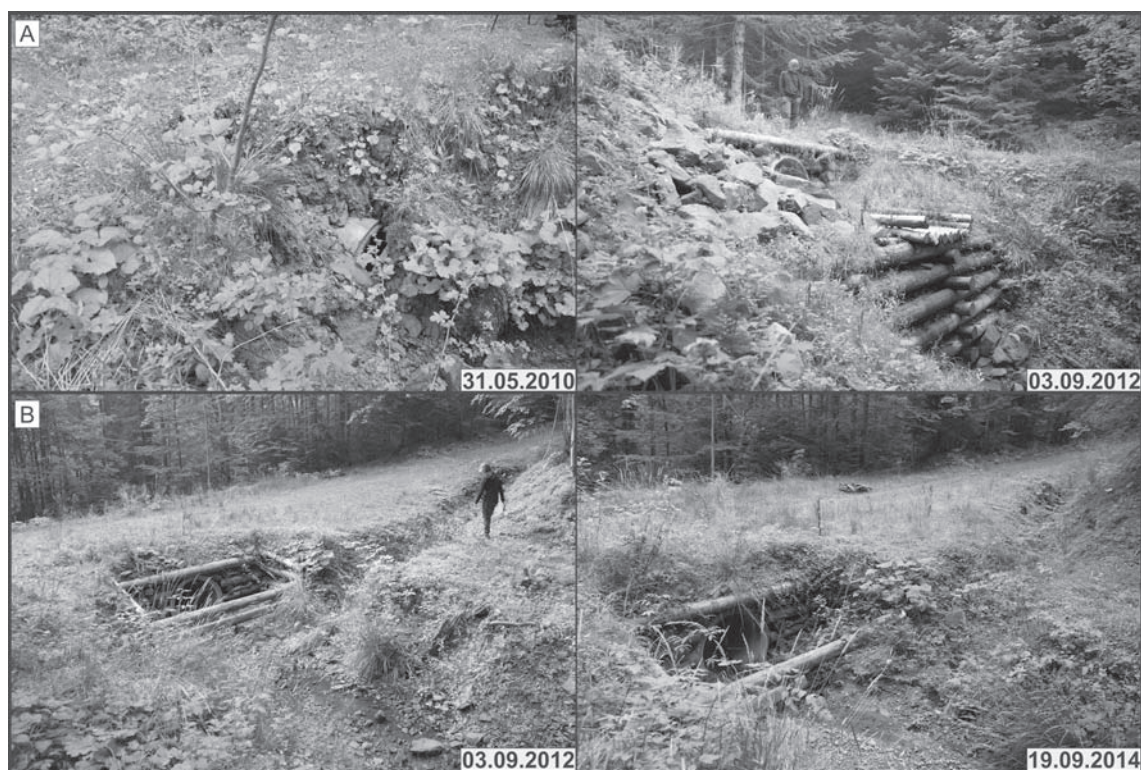
Ryc. 3. A – przepust rurowy (stan przed i po remoncie). Widoczna jest również dylina wyprowadzająca wodę od przepustu; B – studzienka wlotowa zapobiegająca zatykaniu przepustu. Stanowisko DGP20, ścieżka edukacyjna „Dolina Gorcowego Potoku”.
