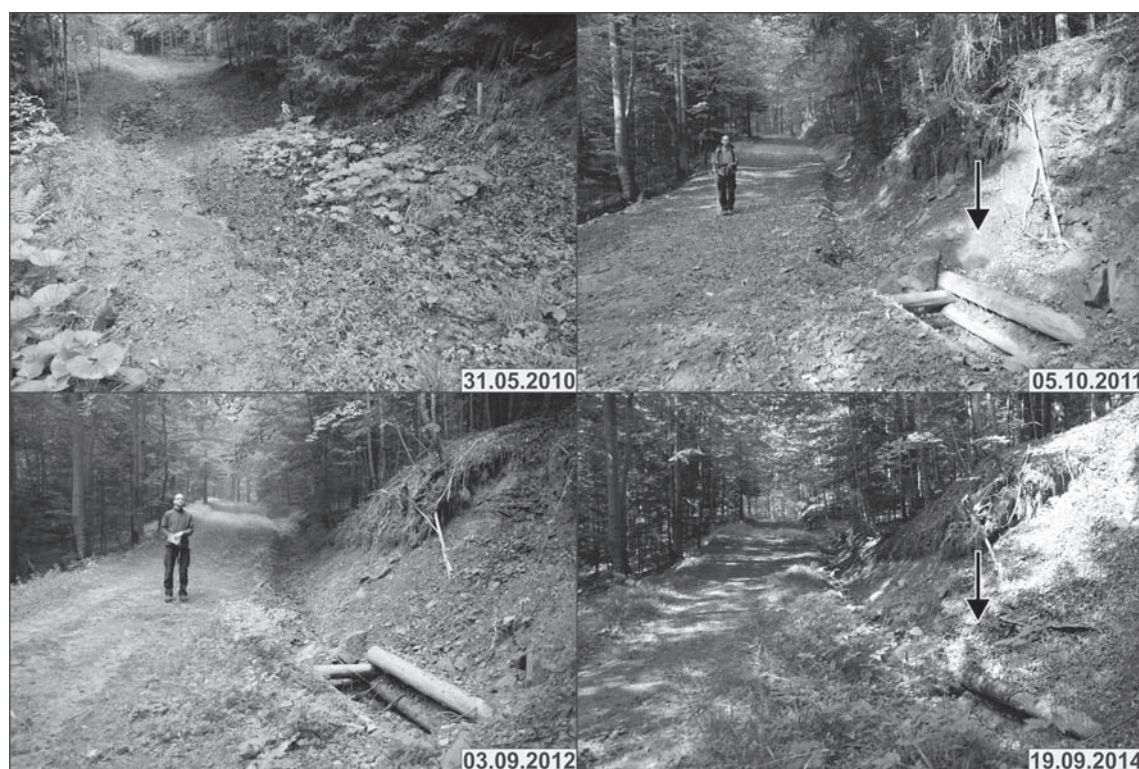
Ryc. 2. Dostokowy rów odprowadzający wodę do przepustu. Strzałkami zaznaczono miejsca, w których dochodziło do osypywania się materiału ze stromo podciętych ścian. Stanowisko DGP18, ścieżka edukacyjna „Dolina Gorcowego Potoku”.
